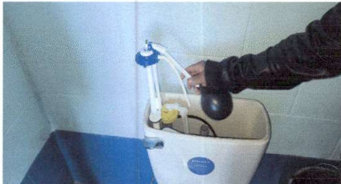
Foto 6: SERVICIOS SANITARIOS Y SUS ACCESORIOS
